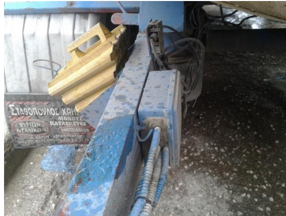
Σχήμα 52. Τριαξονικό επικαθήμενο ημιρυμουλκούμενο όχημα. Κιβώτιο διακλαδώσεων ηλεκτρικών γραμμών πίσω δεξιά.
