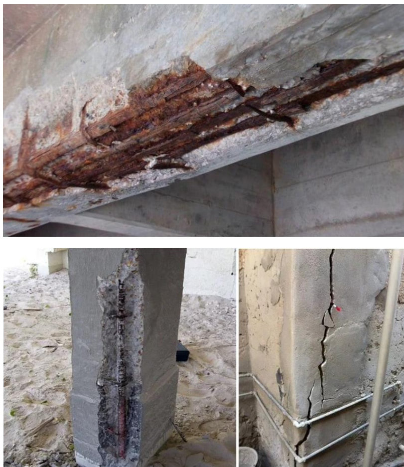
Εικόνα 2-1: Παραδείγματα διάβρωσης οπλισμού και ενανθράκωσης σκυροδέματος.
