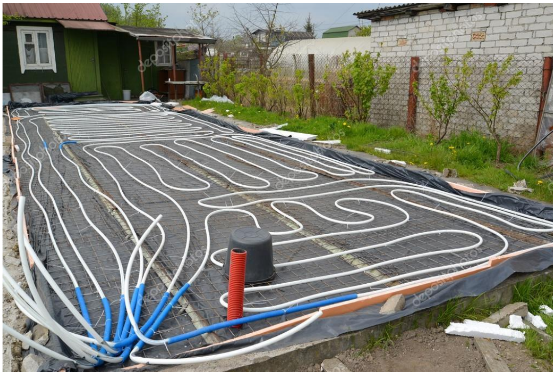
Εικόνα 2.7. Σύστημα ενδοδαπέδιας θέρμανσης θερμοκηπίου ( https://gr.depositphotos.com/ )
