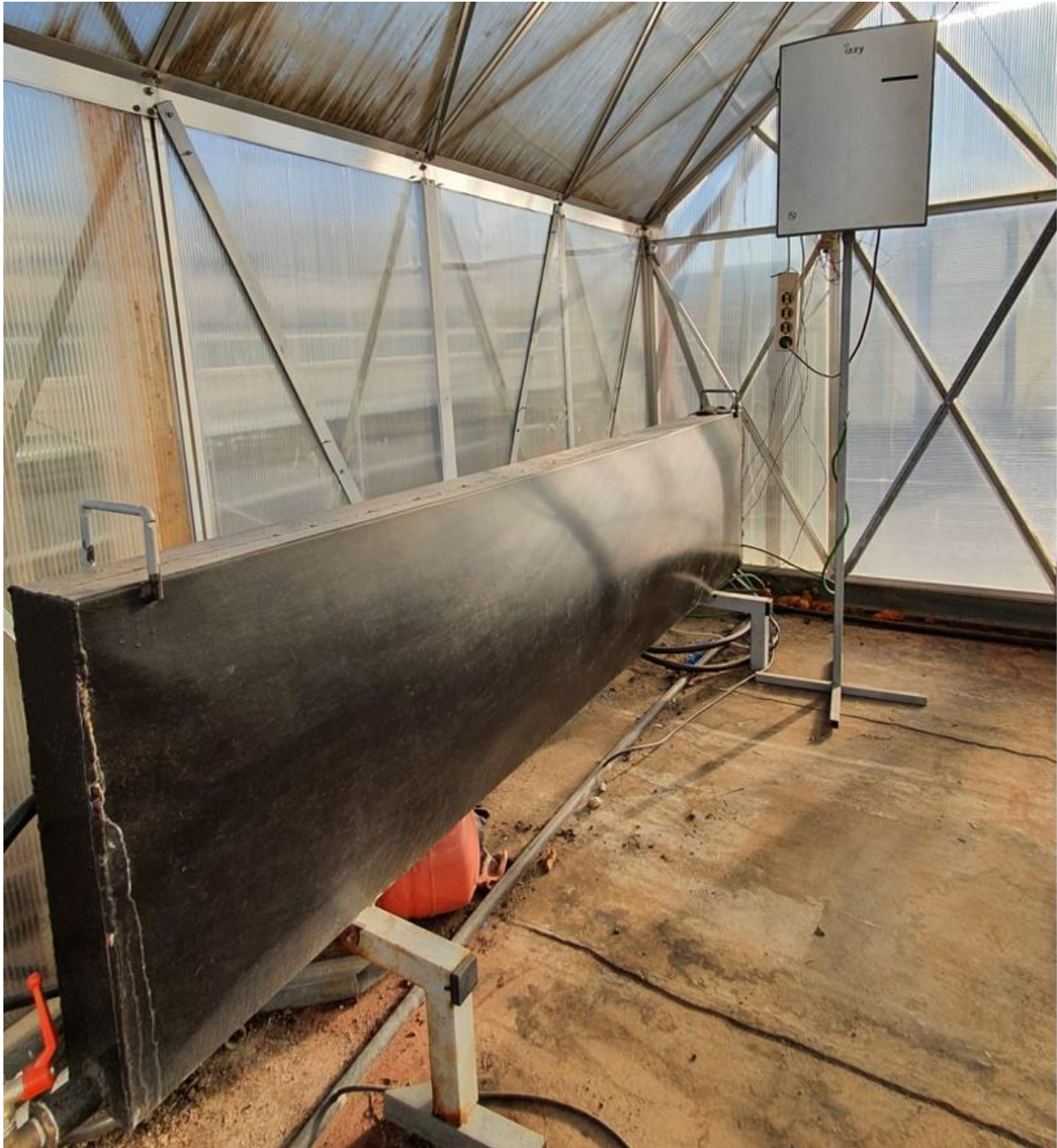
Εικόνα 4.2: Δεξαμενή αποθήκευσης ζεστού νερού (αριστερά) και το αερόθερμο
