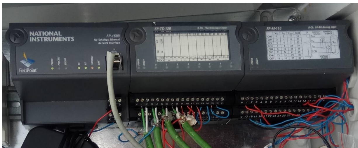
Εικόνα 4.4. Σύστημα λήψης δεδομένων της National Instruments, όπως έχει τοποθετηθεί στην εγκατάσταση.
