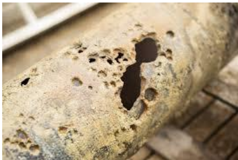
Σχήμα 1.6 Διάβρωση με βελονισμό σε υπόγειο σωλήνα.
