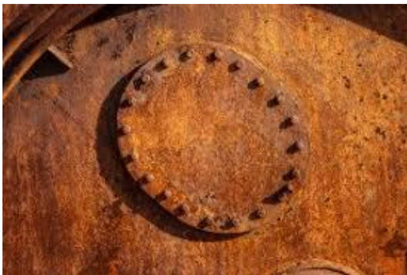
Σχήμα 1.4 Ομοιόμορφη διάβρωση σε δεξαμενή.
