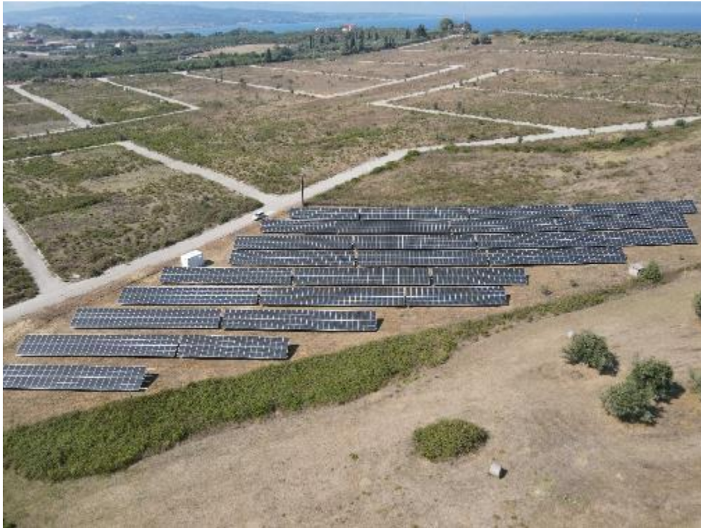
Εικόνα 3.3 Αεροφωτογραφία του φωτοβολταϊκού συστήματος στην θέση Ταράνα.
