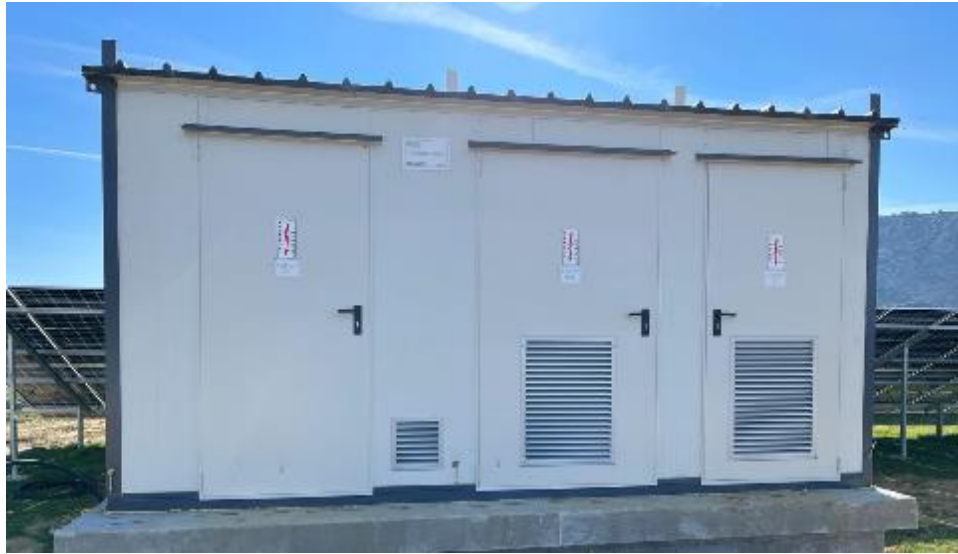
Εικόνα 3.6 Φωτογραφία οικίσκου μετασχηματιστή μέσης τάσης.
