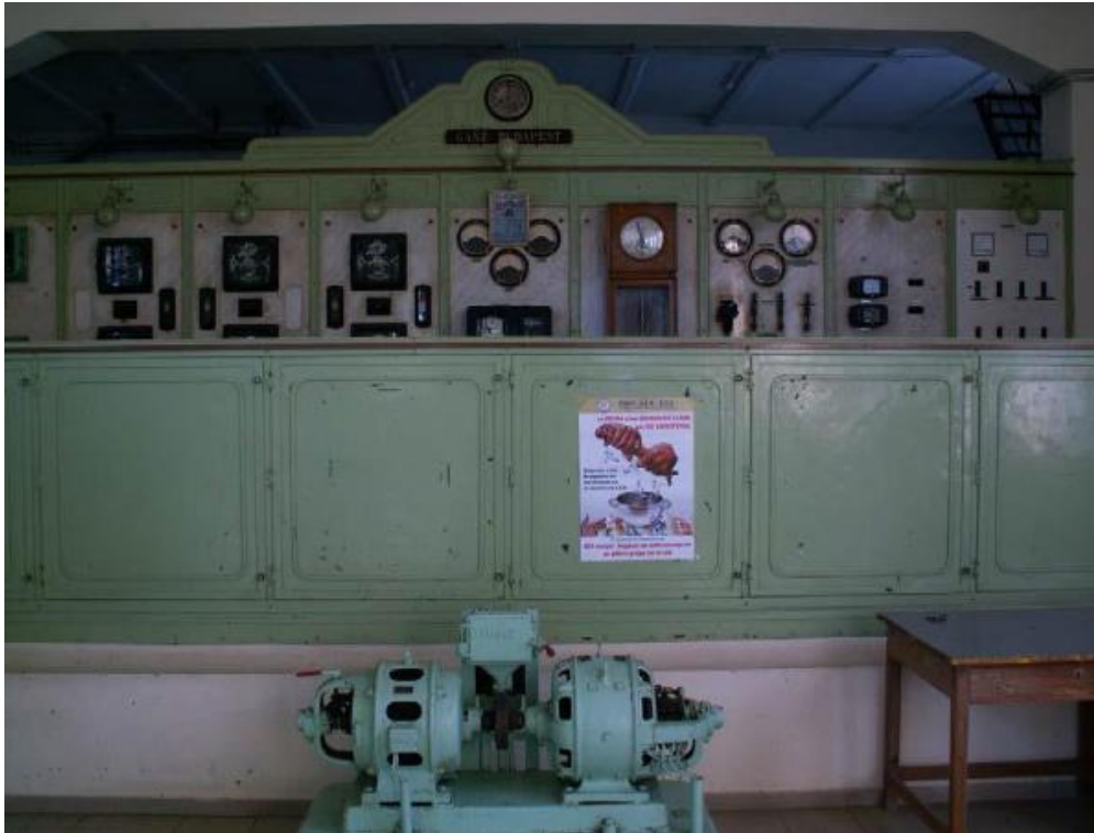
Εικόνα 20. Πίνακας Ελέγχου ΜΥΗΣ Γλαύκου (Πηγή: Ευαγγελάτος, 2016)
