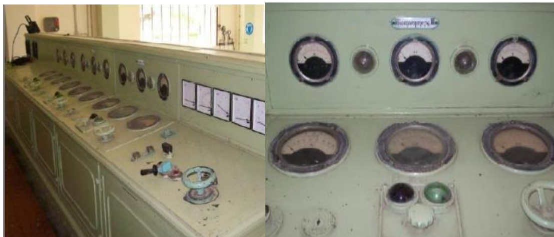
Εικόνα 21 Παλιός Πίνακας Ελέγχου ΜΥΗΣ Γλαύκου (Πηγή: Ευαγγελάτος, 2016)
