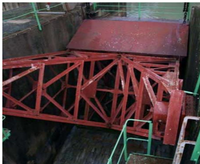
Εικόνα 13. Ηλεκτρικό τοξωτό θυρόφραγμα. (Πηγή: Γεωργίτσας Α. & Σίννης Α., Μελέτης και Περιγραφή του ΜΥΗΣ Γλαύκου, Πτυχιακή Εργασία Τεχνολογικό Εκπαιδευτικό Ίδρυμα Πειραιά Σχολή Τεχνολογικών Εφαρμογών Τμήμα Πολιτικών Δομικών, ΔΕΗ Ανανεώσιμες Α.Ε., 2010)
