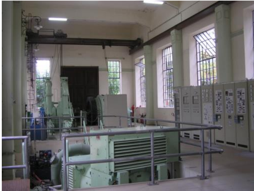
Εικόνα 19. Εσωτερική άποψη σταθμού. Στα δεξιά της φωτογραφίας ο πίνακας ελέγχου και στο βάθος ο στρόβιλος Pelton. (Πηγή: Γεωργίτσας Α. & Σίννης Α., Μελέτης και Περιγραφή του ΜΥΗΣ Γλαύκου, Πτυχιακή Εργασία Τεχνολογικό Εκπαιδευτικό Ίδρυμα Πειραιά Σχολή Τεχνολογικών Εφαρμογών Τμήμα Πολιτικών Δομικών, ΔΕΗ Ανανεώσιμες Α.Ε., 2010)
