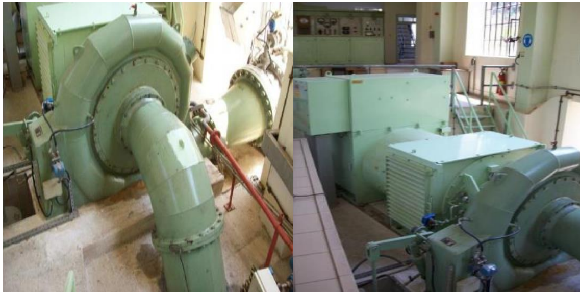
Εικόνα 25. Υδροστρόβιλος Francis και Γεννήτρια (Πηγή: Ευαγγελάτος, 2016)
